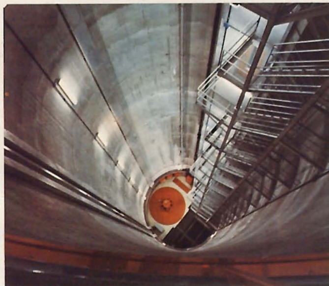
central de Baserca. Pozo
